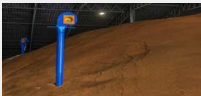
L'aération des grains est essentielle pour maintenir des conditions de stockage optimales.
