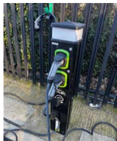
Alltech ha instalado estaciones de recarga de vehículos eléctricos en muchas de nuestras instalaciones.
