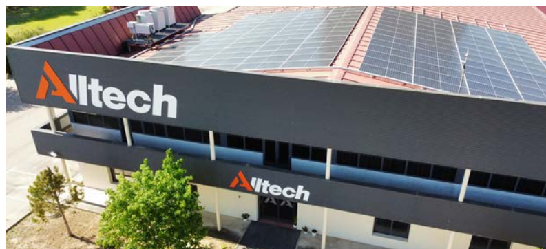
Alltech España cuenta con dos campos fotovoltaicos, uno de ellos en el tejado.
